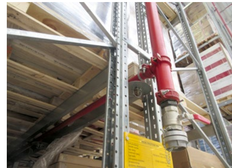
Tryskacze w instalacji regałowej chronią przed pożarem magazynowane towary.
