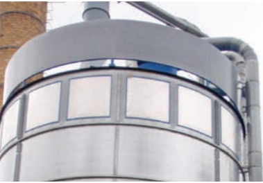
Panela odciążające umieszczone na silosie.
